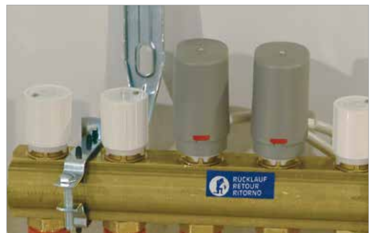
Рисунок 9. Электротермические сервоприводы, установленные на коллектор.
