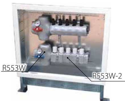
Рисунок 19. Установленный в шкаф коллектор с теплоизолирующими оболочками.
